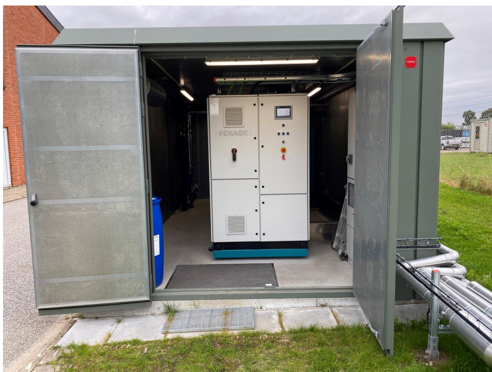
Figur 3 - Containerløsning med luft til vand varmepumpe fra FENAGY på 1,8 MW.
